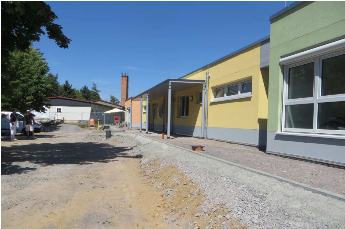
Die Außenanlagen im direkten Umfeld des Kita-Neubaus werden bis Anfang August gestaltet.
